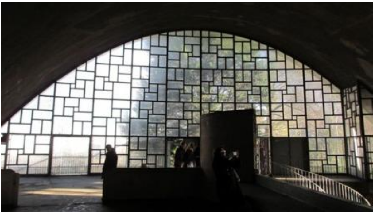
A l'intérieur de la chaufferie des Tarterêts, en 2014. (DRAC Ile-de-France, CRMH, photographie Xavière Desternes)
